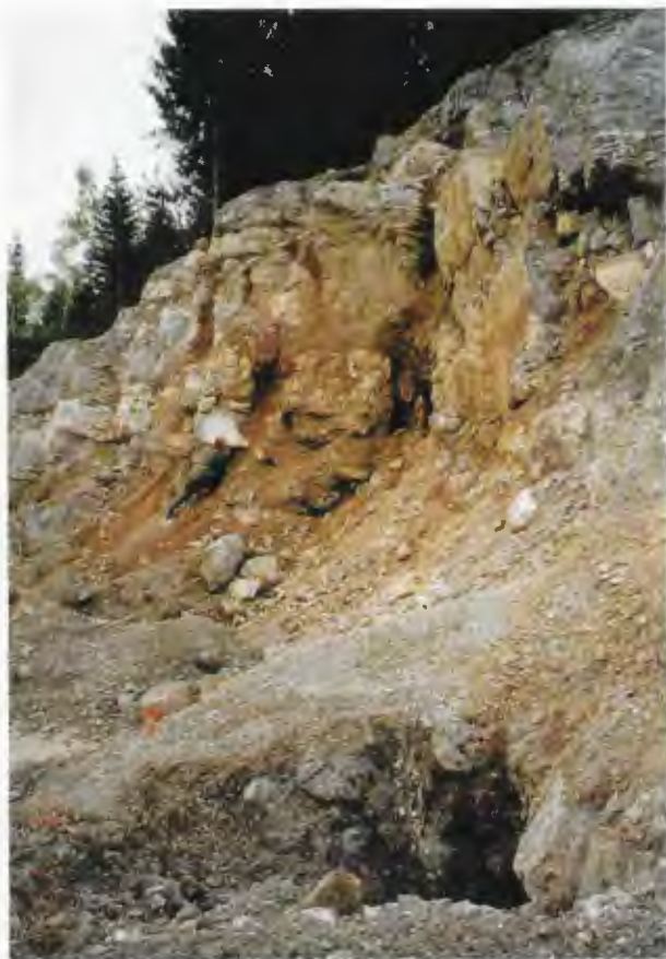
Sl. 2 Rasjedna zona i jama, km 63+760. Fig. 2 Fault zone and the pit, km 63+760.
